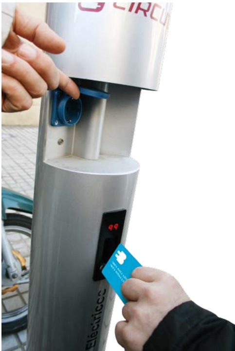
Punto de recarga para vehículos eléctricos
