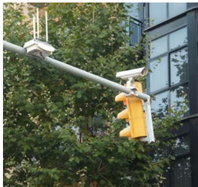
Cámaras de control de tráfico conectadas por fibra óptica con la central de vía pública para controlar en tiempo real el tráfico. Se podrá aumentar o reducir la frecuencia del verde en función de las necesidades del momento
